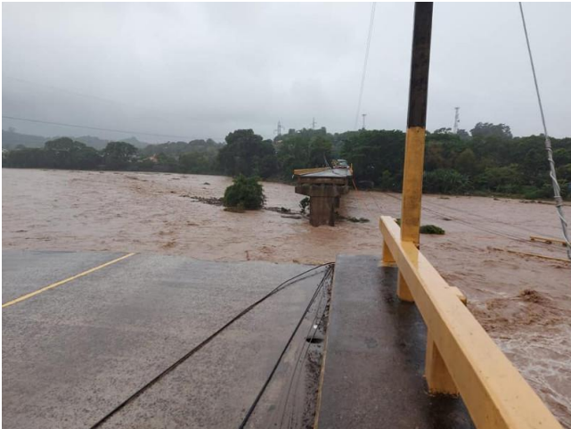
Eine von vielen: Die Saopin Brücke in Honduras stürzte ein, Quelle: radiodignidad
